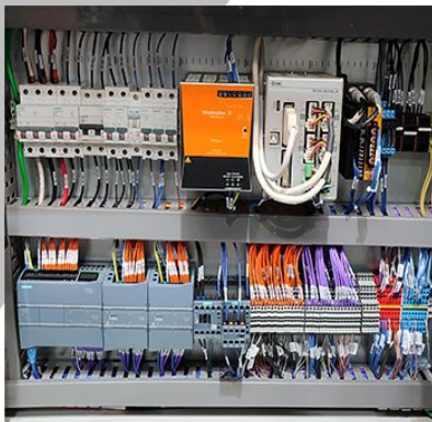
Programación plc Gabinetes de control
