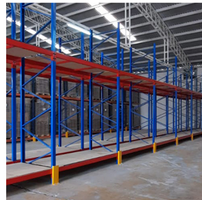
Estanterías de almacén
